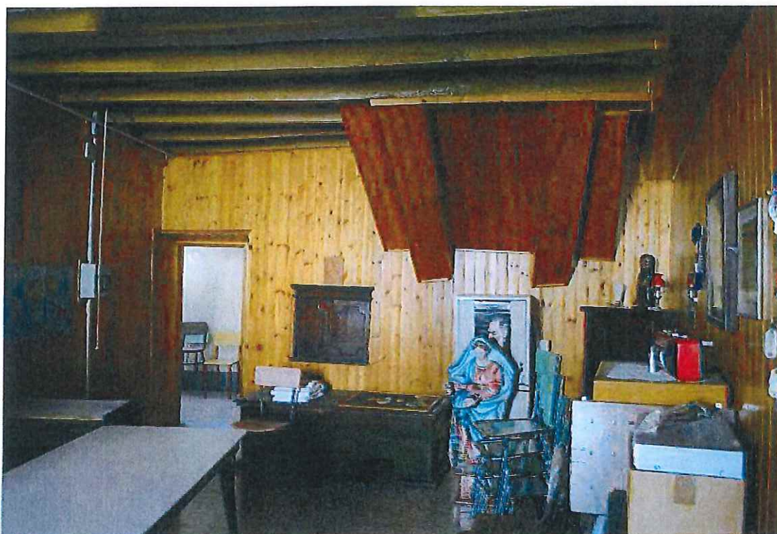
Fig.19 | Primo piano: sala relax, particolare del rivestimento in legno e del solaio ligneo.
