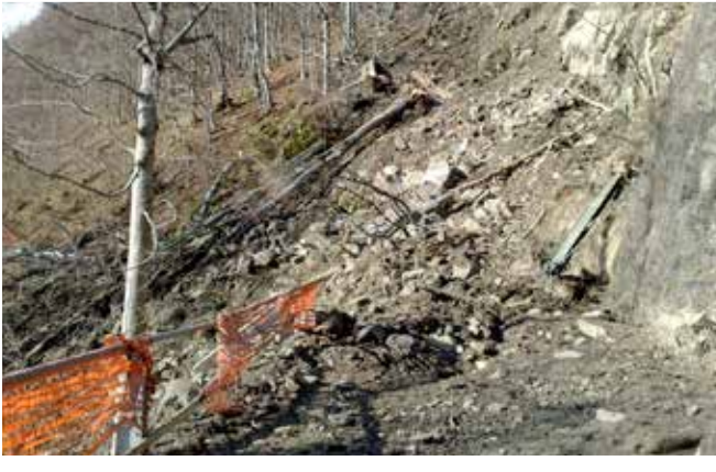
Frana strada Tagliole
