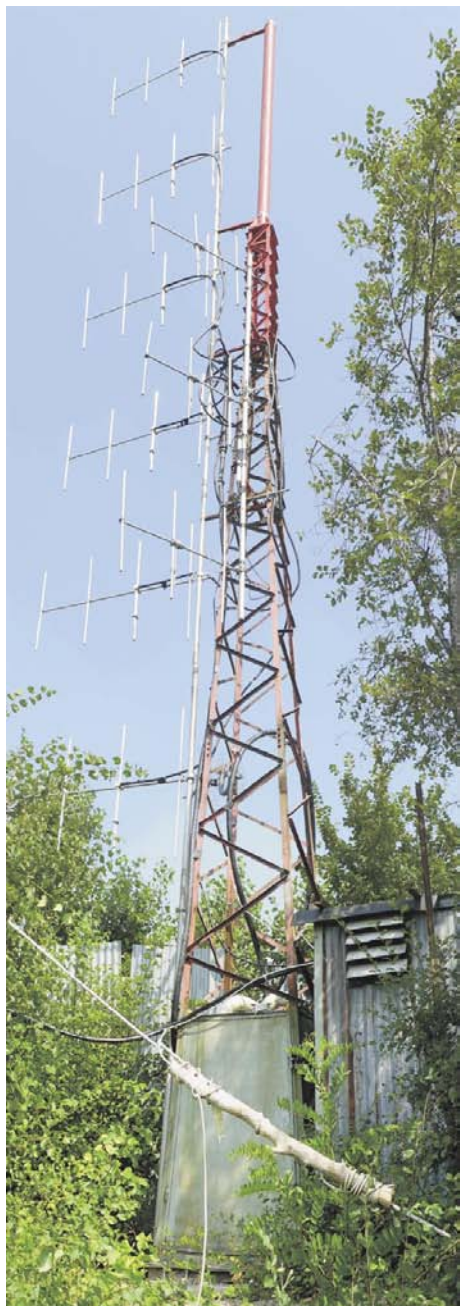
Traliccio abusivo in loc. Casa Cavana
