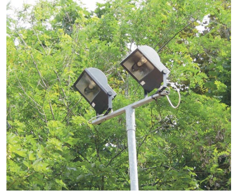
Impianto illuminazione campi tennis
